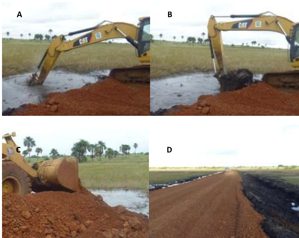
Fotos: A e B - Escavadeira removendo solo orgânico da base do talude. C – Pá carregadeira empurrando material de alta qualidade para formar a base do talude. D - Talude de açude construído com material da encosta e recoberto com solo orgânico.
