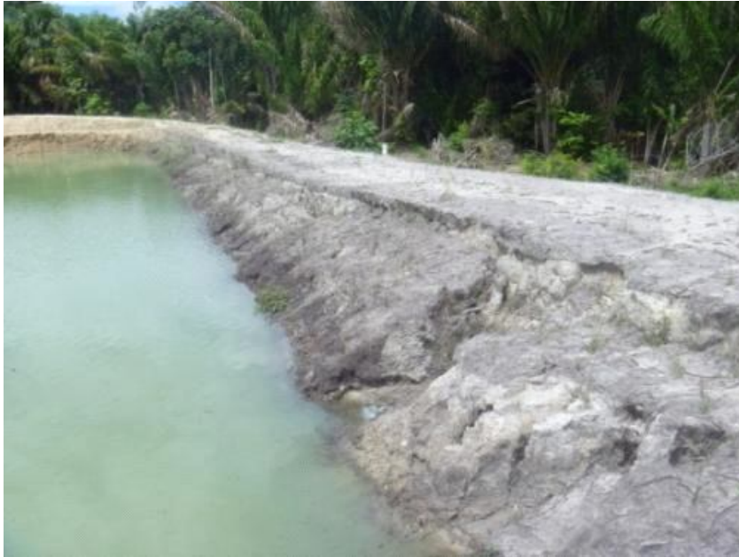
Foto: Taludes construídos com solos de má qualidade, com excesso de material orgânico, já mostrando problemas de desmoronamento.
